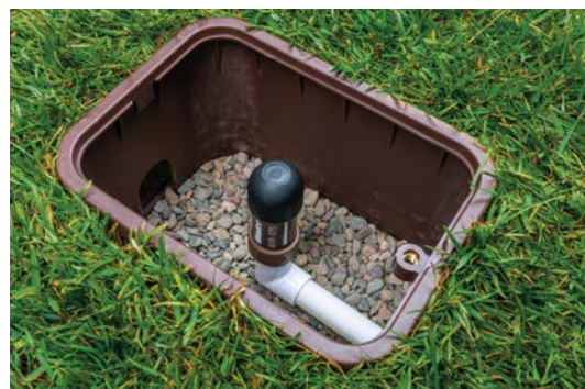
Électrovanne de purge air/vide installée
