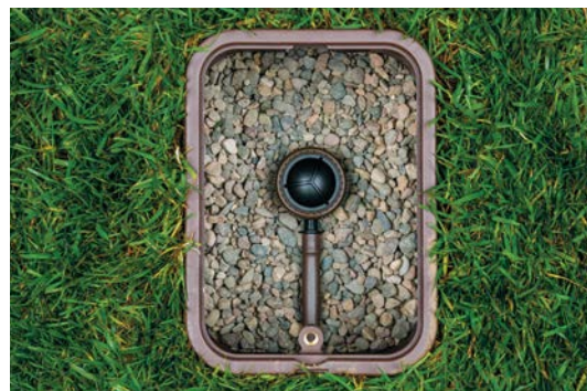
Électrovanne de purge automatique installée
