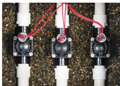
Électrovanne PGV-100G installée
